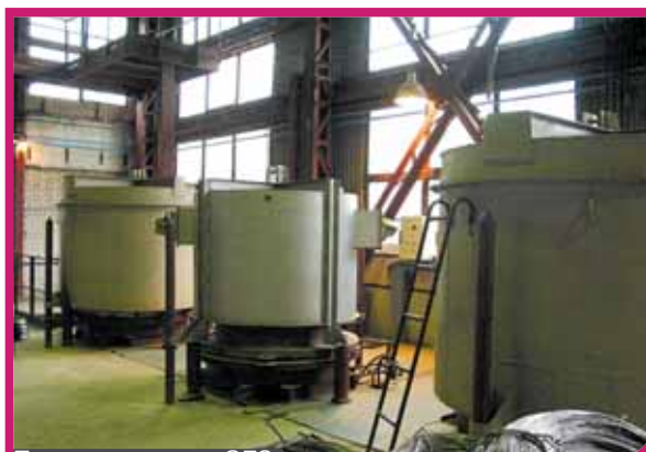
Три стенда печи СГЗ
